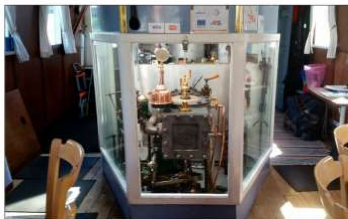
Komoundmaskinen i RUNN är på 40 ind hk och har strålkondensor. Den oljeeldade pannan har en ljuddämpande skärm som dras ned framför brännaren. Hela maskinrummet är väl synligt genom glasrutor från salongen. Foto 9 juli 2017.
